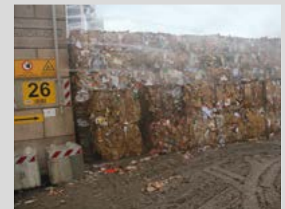
Abschluss der Löschanlage mit der offenen Seite der Lagerbox
