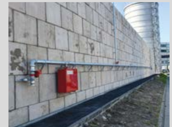
Einspeisestelle der Löschanlage an der Rückseite der Lagerbox
